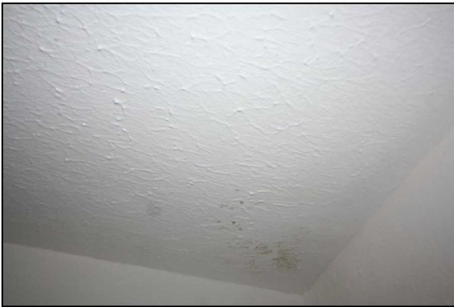
Geometrische Raum-Ecke - Wand/Decke - Schimmel Aspergillus
